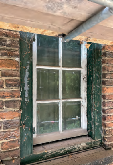
Het buitenschilderwerk was behoorlijk vervuild, verkleurd en verweerd met open verbindingen
