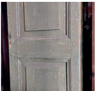
Tijdens de inspectie bleek dat het binnenschilderwerk van de kozijnen, ramen en binnenluiken sterk was gedegradeerd
